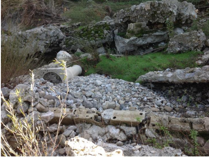
Photo 5 Installations détruites par les crues du Gardon
