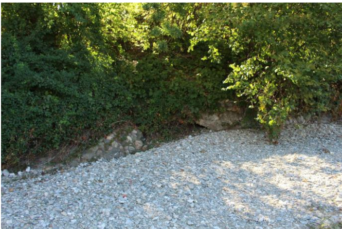
Photo 8 Vestige d'enrochement de la berge de la zone Ng
